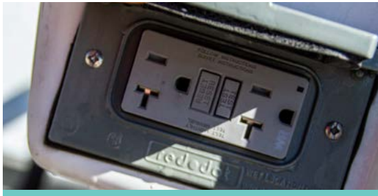
120 volt outlet at platform
